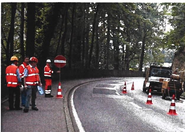
2 In caso di sosta breve (massimo 1 ora) per un controllo sul cantiere o un sopralluogo, nelle pressi delle strade è necessario indossare come minimo degli indumenti di classe 2 (torso coperto).
