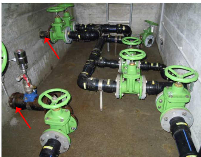
Foto 13: armature idrauliche nella camera di manovra al piano inferiore (le frecce indicano i passaggi murali corrosi)
