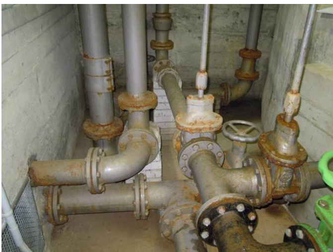
Foto 23: armature idrauliche nella camera di manovra al piano inferiore
