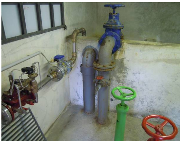
Foto 29: armature idrauliche nella camera di manovra al piano superiore e vaschetta di raccolta in entrata senza separazione
