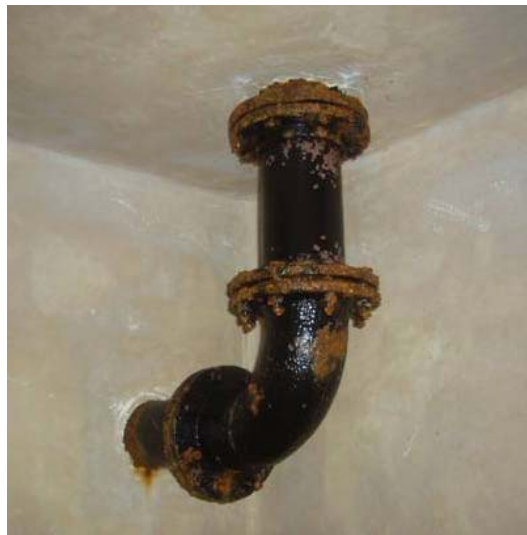
Foto 6: vasca di accumulo: armature idrauliche corrose
