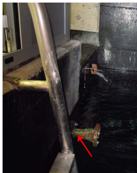
Foto 14: scarico troppo pieno corrosivo
