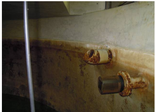
Foto 22: rivestimento vasca principale e armature idrauliche corrose
