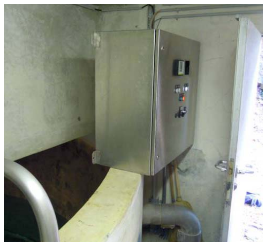
Foto 30: la vasca di accumulo principale non è separata dalla camera di manovra al piano superiore
