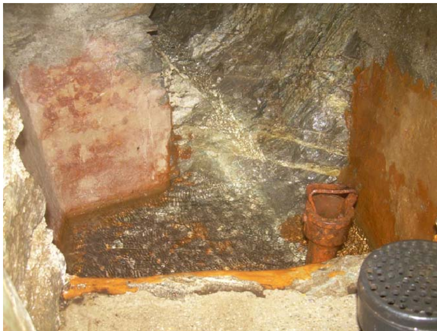
Foto 3: captazione sorgente Superiore, interno
