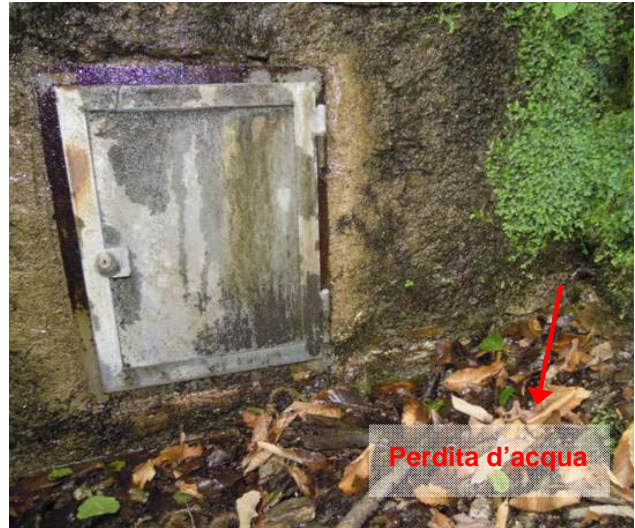
Foto 2: captazione sorgente Superiore
