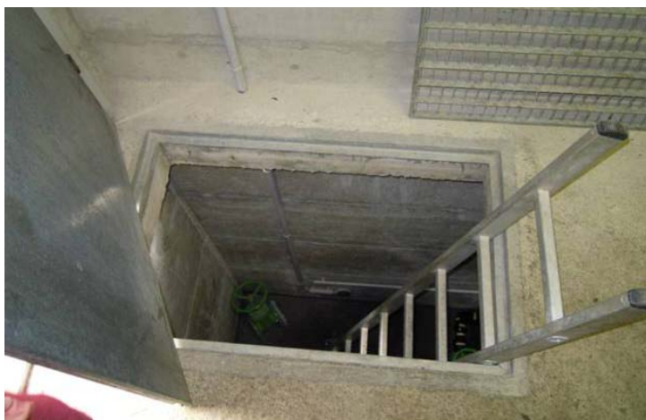
Foto 15: accesso alla camera di manovra al piano inferiore
