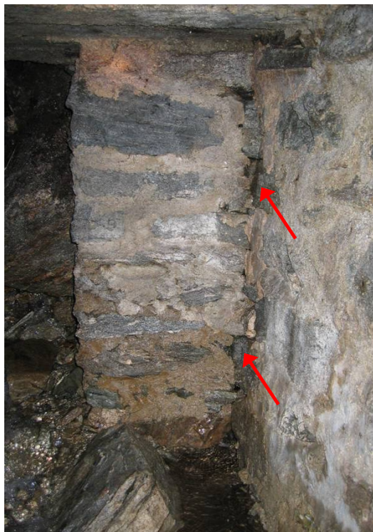
Foto 7: captazione sorgente Inferiore, muri interni fessurati (infiltrazioni)
