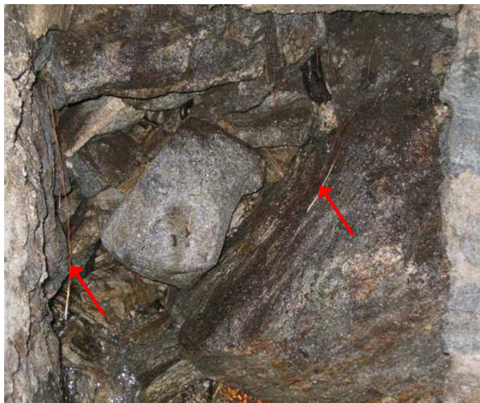
Foto 8: captazione sorgente Inferiore, penetrazione di radici (infiltrazioni)
