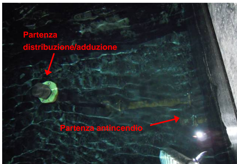
Foto 16: vasca principale, condotte in uscita
