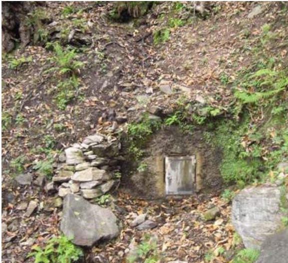
Foto 1: captazione sorgente Superiore
