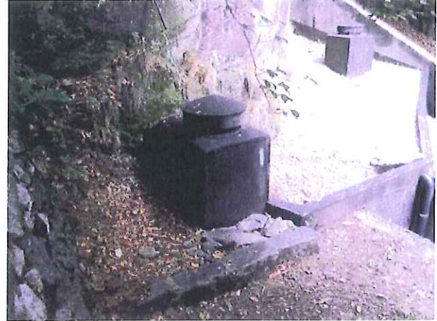
Foto 2. Camini di ventilazione.
