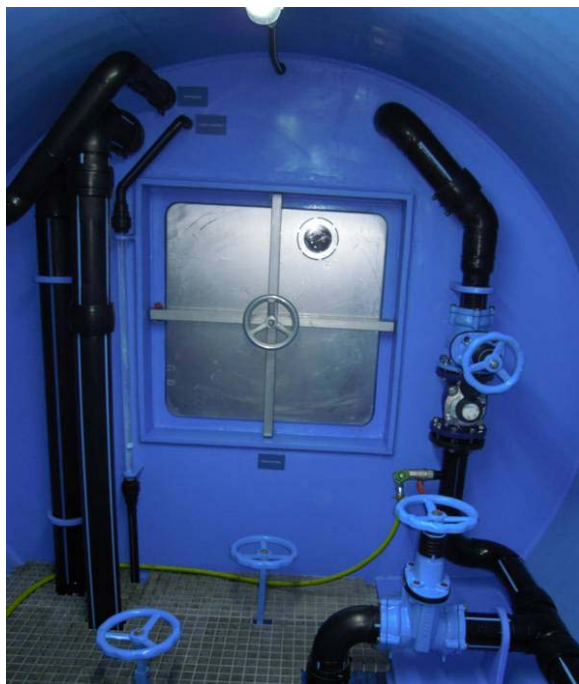
Foto 1: esempio: interno di un serbatoio prefabbricato in PE
