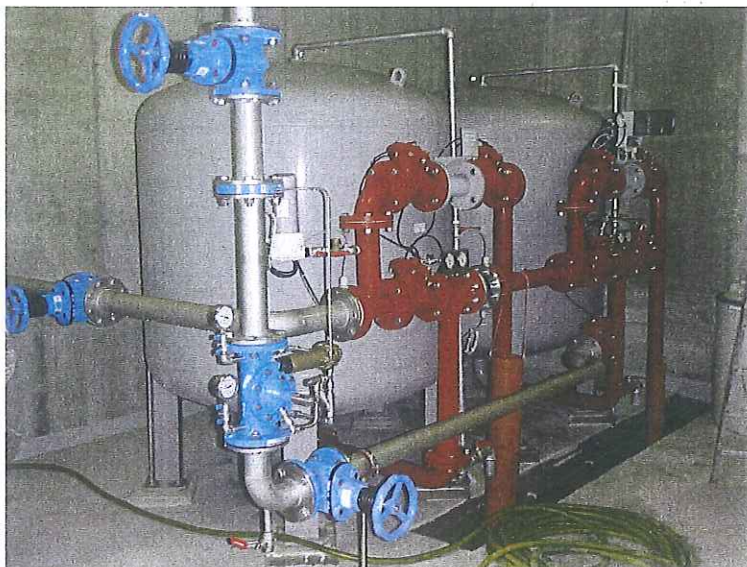
Figura 1: Impianto di filtrazione
