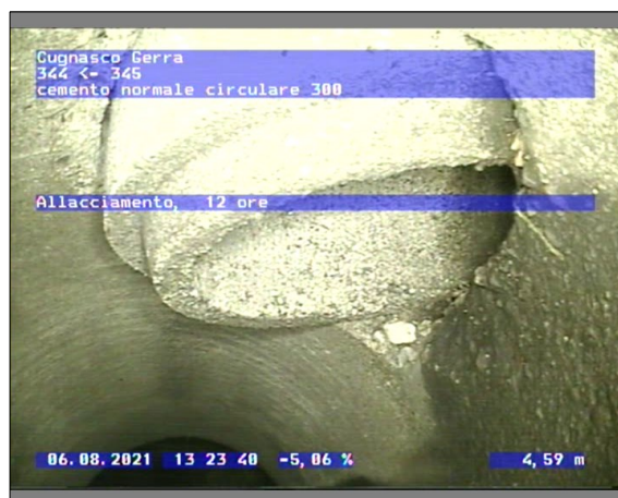
Fotografia: 16_16_74_A.JPG 4.59m, Allacciamento, 12 ore
