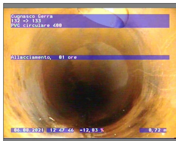
Fotografia: 12_12_56_A.JPG 0.72m, Allacciamento, 01 ore
