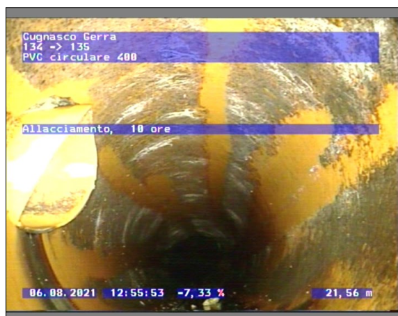
Fotografia: 14_14_67_A.JPG 21.56m, Allacciamento, 10 ore
