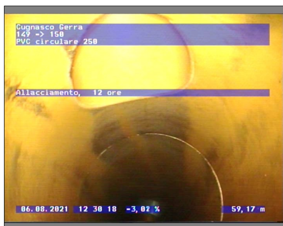
Fotografia: 10_10_49_A.JPG 59.17m, Allacciamento, 12 ore
