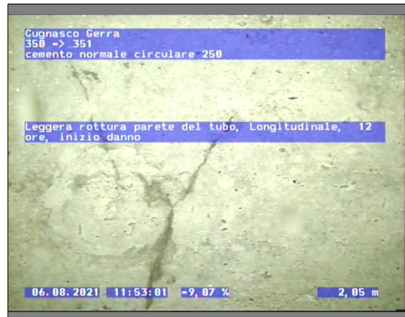
Fotografia: 8_8_30_A.JPG 2.05m, Leggera rottura parete del tubo, Longitudinale, 12 ore, inizio danno
