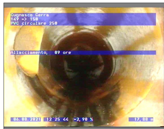
Fotografia: 10_10_46_A.JPG 17.88m, Allacciamento, 09 ore
