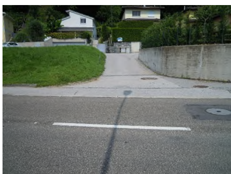
Foto 3: Stato pavimentazione Via Locarno
