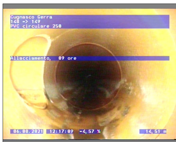
Fotografia: 9_9_41_A.JPG 14.51m, Allacciamento, 09 ore
