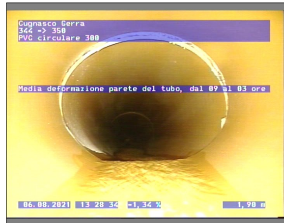
Fotografia: 17_17_77_A.JPG 1.9m, Media deformazione parete del tubo, dal 09 al 03 ore
