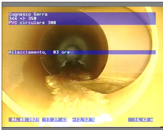
Fotografia: 17_17_78_A.JPG 14.42m, Allacciamento, 03 ore
