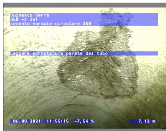
Fotografia: 8_8_32_A.JPG 7.12m, Leggera scrostatura parete del tubo
