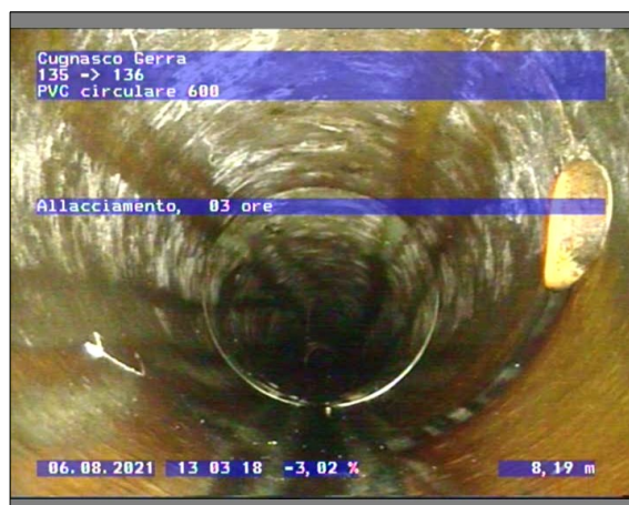
Fotografia: 15_15_70_A.JPG 8.19m, Allacciamento, 03 ore
