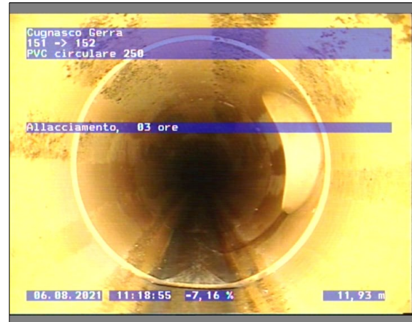
Fotografia: 4_4_16_A.JPG 11.93m, Allacciamento, 03 ore
