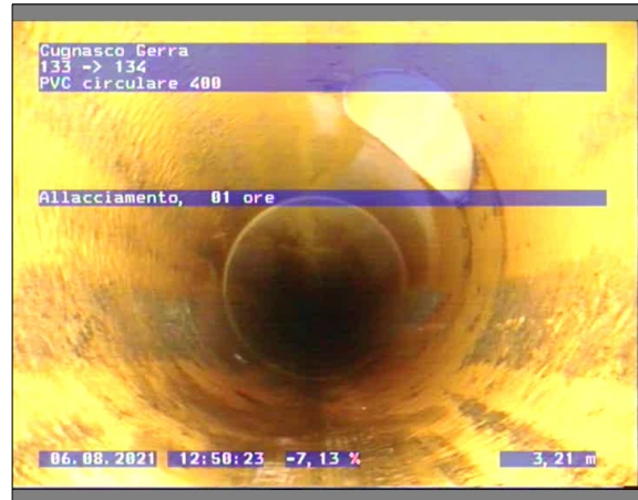
Fotografia: 13_13_59_A.JPG 3.22m, Allacciamento, 01 ore
