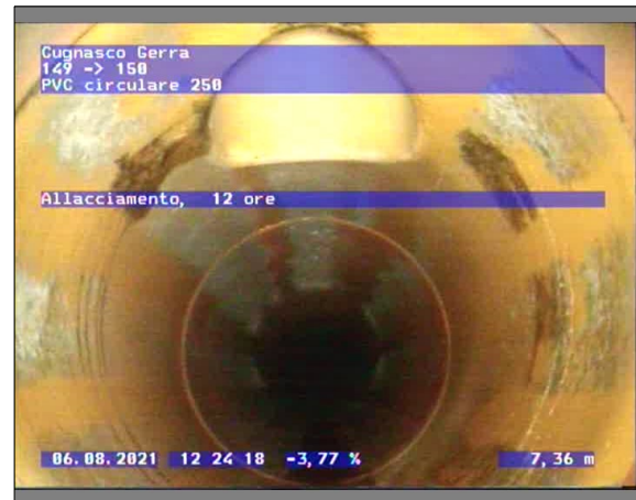
Fotografia: 10_10_44_A.JPG 7.36m, Allacciamento, 12 ore
