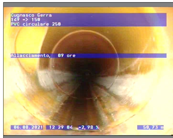
Fotografia: 10_10_48_A.JPG 50.73m, Allacciamento, 09 ore
