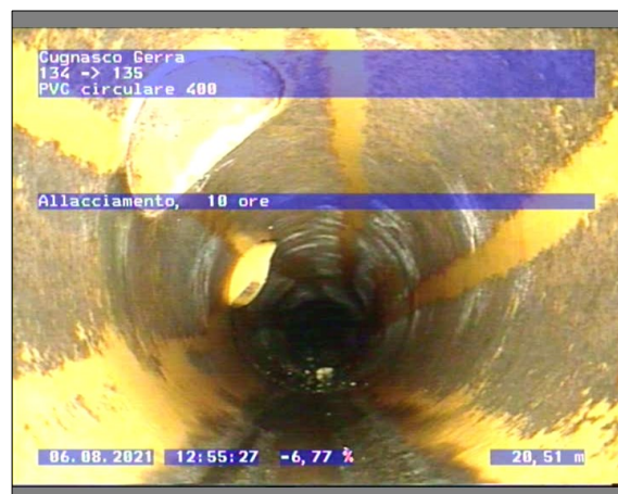
Fotografia: 14_14_66_A.JPG 20.52m, Allacciamento, 10 ore
