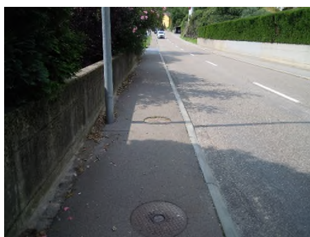
Foto 2: Stato pavimentazione strada cantonale
