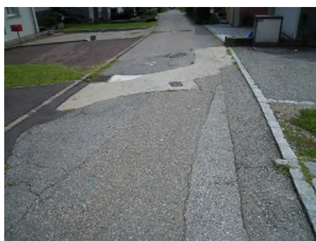
Foto 4: Stato pavimentazione Via Massarescio
