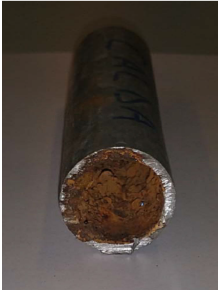
Tubi di distribuzione acqua calda
