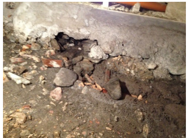
Collettore di scarico nel vespaio (rotto)
