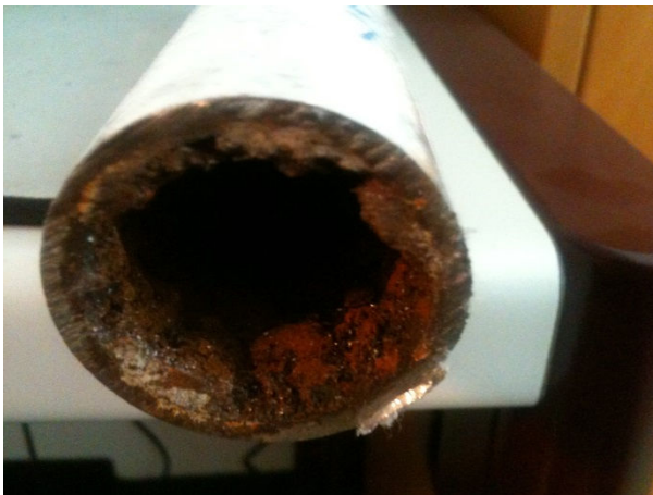
Condotte idriche (prelievo in distribuzione principale)
