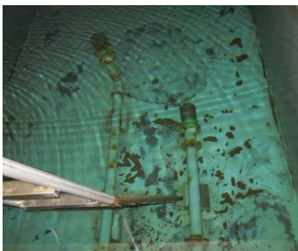
Foto 6: vasca d'accumulo principale
