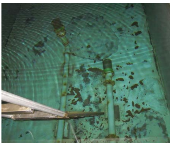
Foto 6: vasca d'accumulo principale
